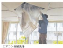
エアコン分解洗浄
